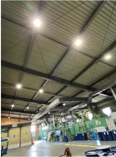
3号エリア天井照明
